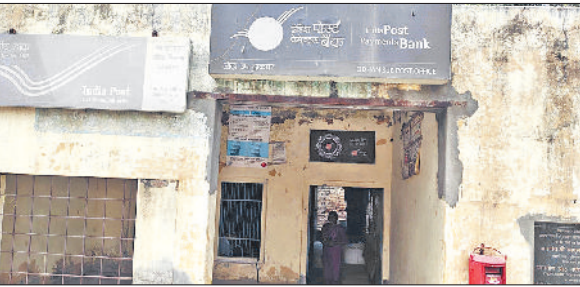
सिरसा। जर्जर डाकघर का भवन।
